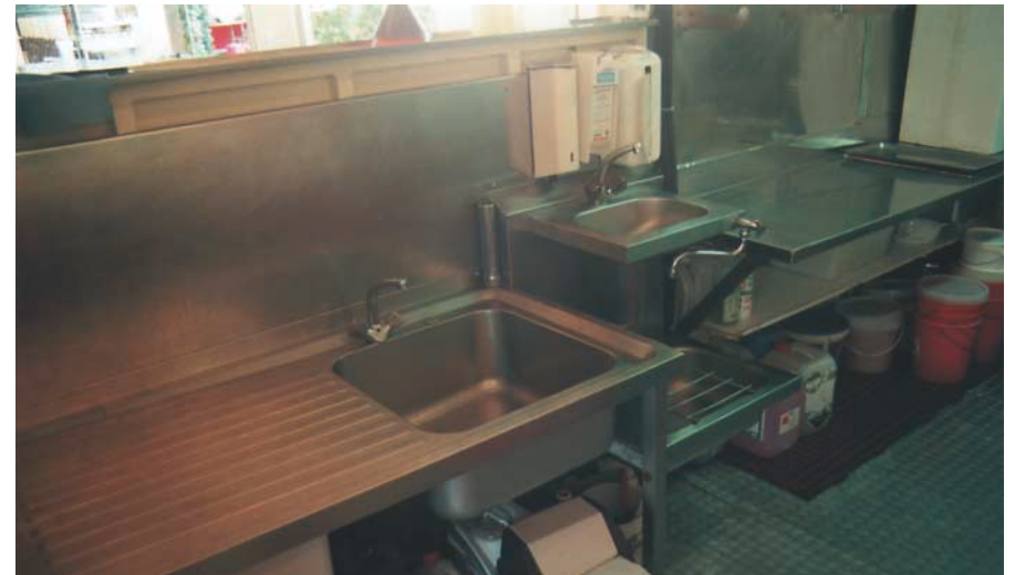
Abb. 7: Gute Lösung in einem großen Unternehmen: Handwaschbecken getrennt von der Spüle und mit gesondertem Ausguss unterhalb des Handwaschbeckens
