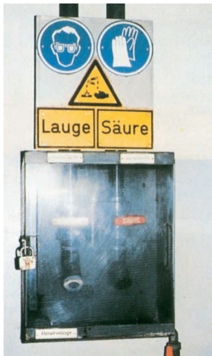
Abb. 6: Kennzeichnung der Anschlüsse von Rohrleitungen
